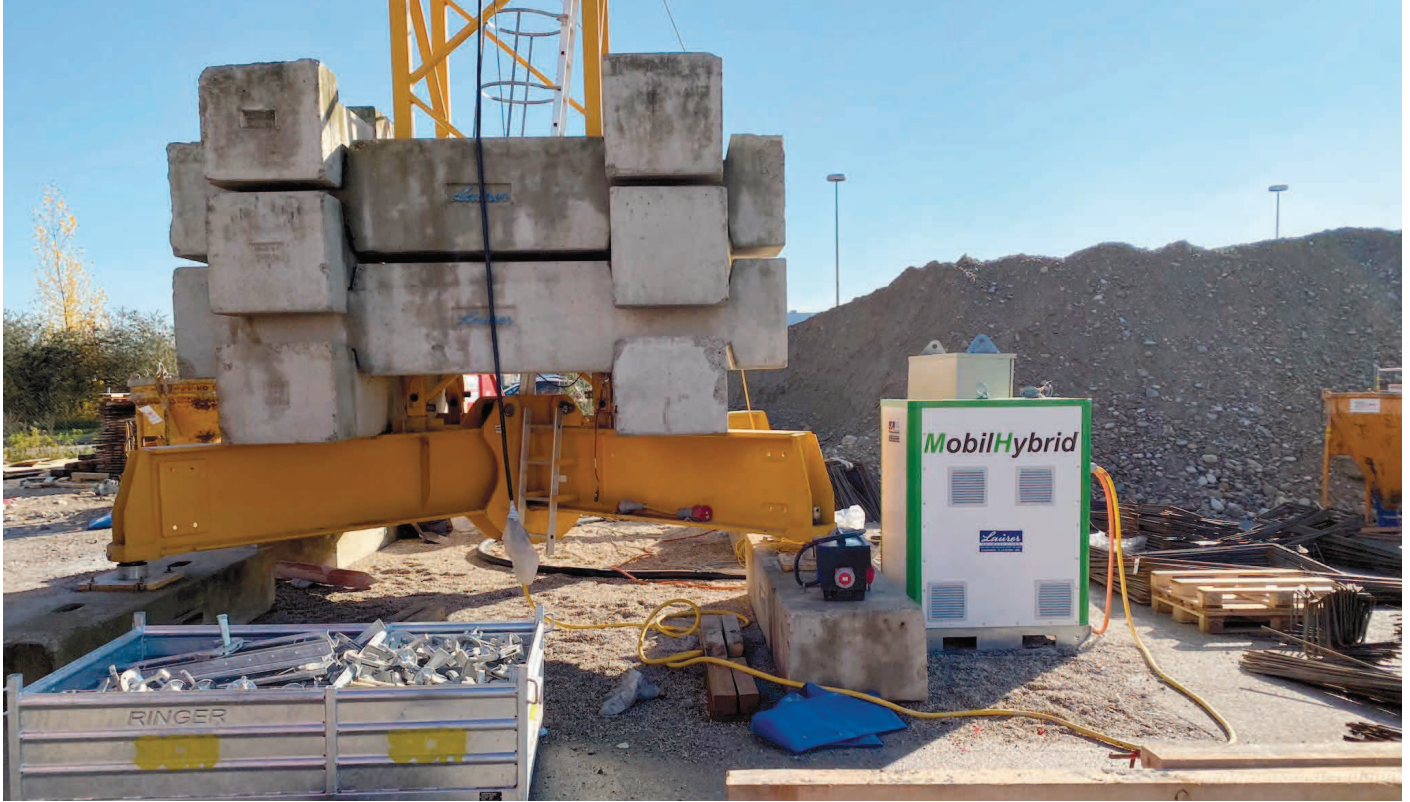
Zwei Stunden Ladezeit benötigen die mobilen Stromspeicher von Mobilhybrid.
