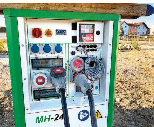
Spitzenlasten bis zu 125 A puffert der Mobilhybrid aus der Batterie..
